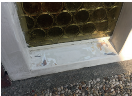
Kozijn voordeur is gerepareerd met 2 componenten plamuur. (kan niet waargenomen worden of de houtrot tot schoon hout is verwijderd)
